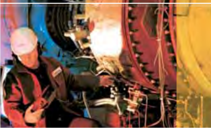
Gasturbine für Wärme-Kraft-Kopplungsanlage
