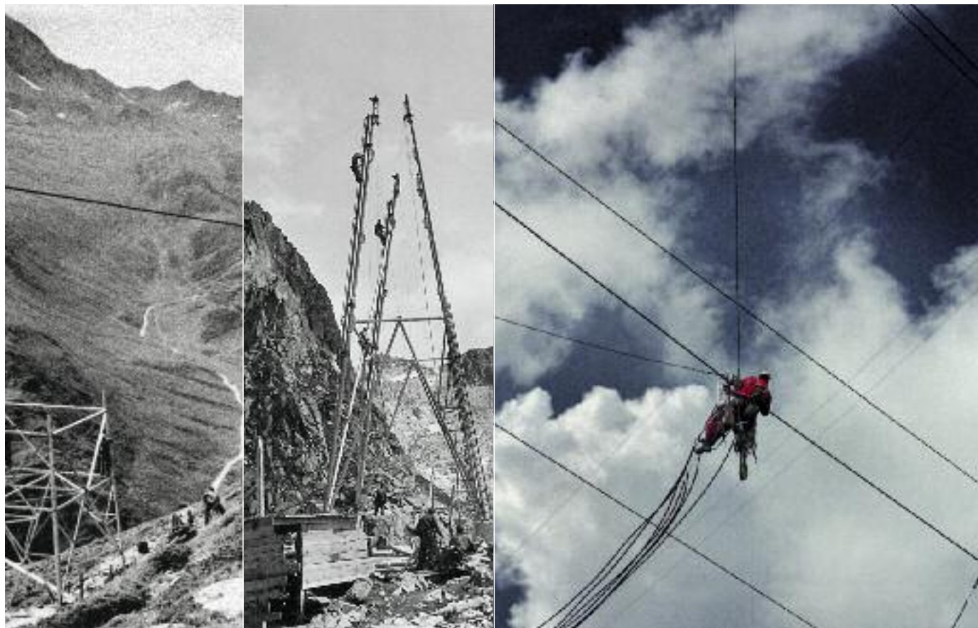
Montage de pylônes lors de la construction de la ligne 220 kV du Col du Grand St.-Bernard en 1955
